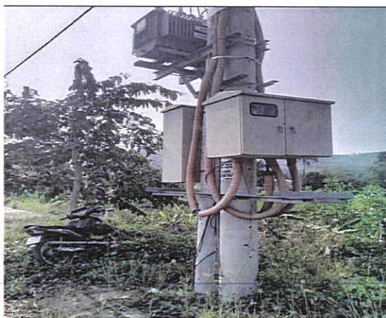
Trạm biến áp Khu TĐC hiện hữu
