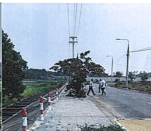
Đường dây 22Kv và đường dây 0,4Kv
